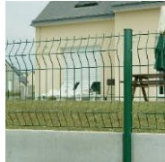
Installatie met betonplaat
