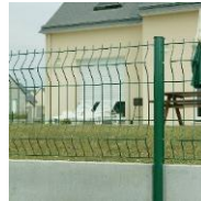
Installatie met betonplaat
